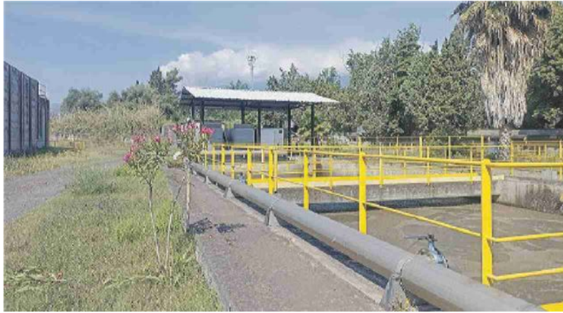
L'impianto di depurazione consortile a Sant'Anna di Mascali
