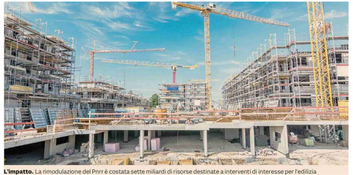
L'impatto. La rimodulazione del Pnrr è costata sette miliardi di risorse destinate a interventi di interesse per l'edilizia
